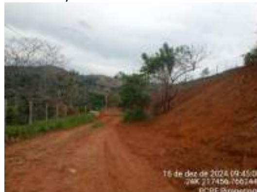
Foto 59 Visão geral de melhorias na base do acesso da chaminé de equilíbrio da PCH Pirapetinga – dezembro/2024.
