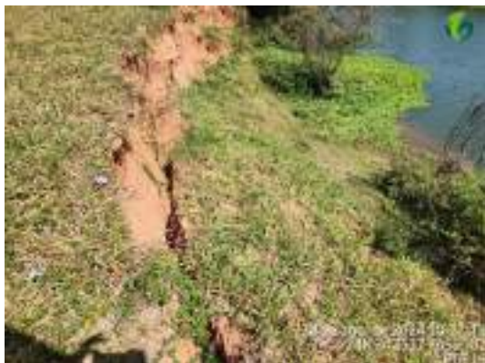
Foto 57 Formação de um novo processo erosivo na Área 5 / Setor 1C (PGF 18) na PCH Pedra do Garrafão.
