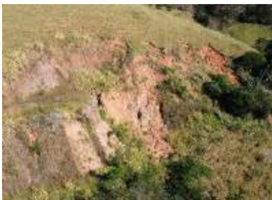
Foto 50 Visão geral do Ponto PIR27 no acesso da chaminé de equilíbrio da PCH Pirapetinga – junho/2024.
