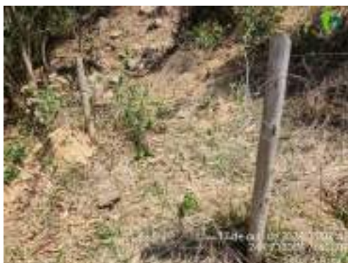
Foto 10 Cerca danificada no Setor 5 (área 1), na PCH Pirapetinga.
