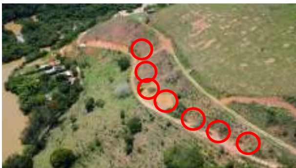
Foto 54 Visão geral das caixas de contenção instaladas no acesso da chaminé de equilíbrio da PCH Pirapetinga – dezembro/2024.
