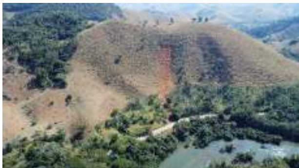
Foto 74 Formação de processo erosivo acima da Área 1 / Setor 4 na PCH Pirapetinga (dez/24).
