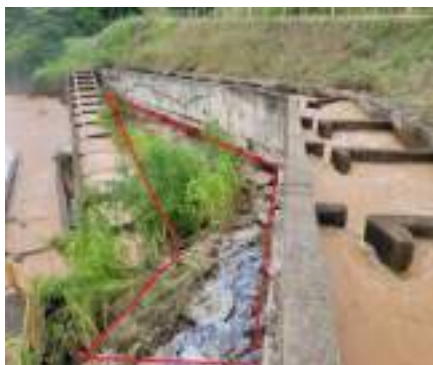
Foto 90 Local onde foi encontrado a erosão na escada de peixe da PCH Pedra do Garrafão.
