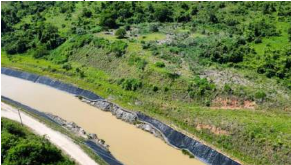
Foto 87 Visão Geral do ponto PIR17B na PCH Pedra do Garrafão em dezembro de 2024
