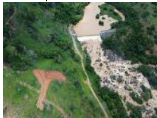
Foto 57 Visão geral das canaletas de crista instaladas no ponto PIR29 da PCH Pirapetinga – dezembro/2024
