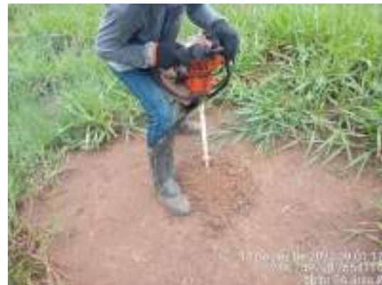
Foto 22 Coveamento no setor 2 na PCH Pedra Garrafão.
