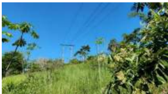
Foto 200 Área 3 do Setor 2 – Vista da Linha de distribuição de energia.
