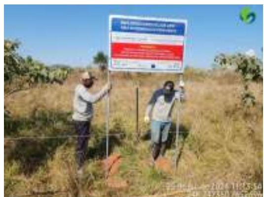
Foto 22 Instalação novas placas da APP da PCH Pedra do Garrafão (Setor 1A).
